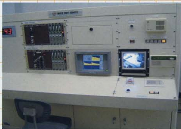
ホールボディカウンタ制御部
